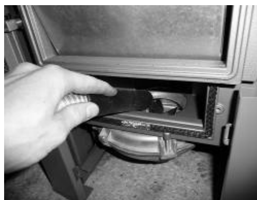
Figuur 15 - stofzuigen rookgasventilator
